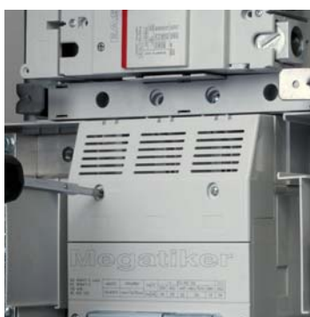
CUBIERTA AISLANTE INTERRUPTOR PRINCIPAL
